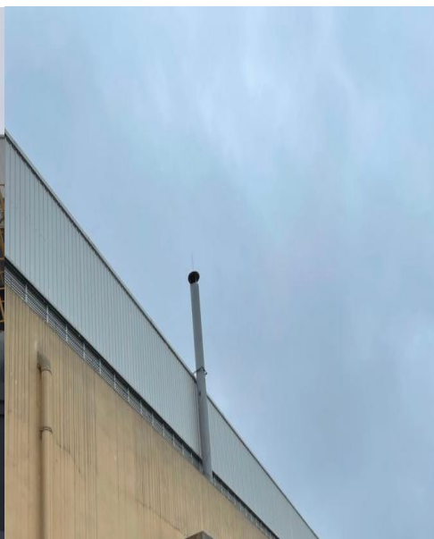
20mDA002 天然气退火炉排气筒
