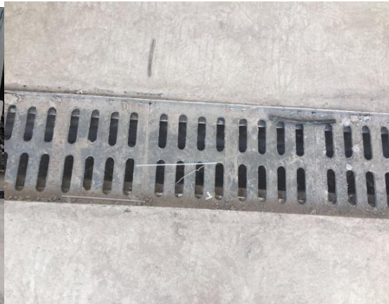
危险废物贮存设施截流沟
