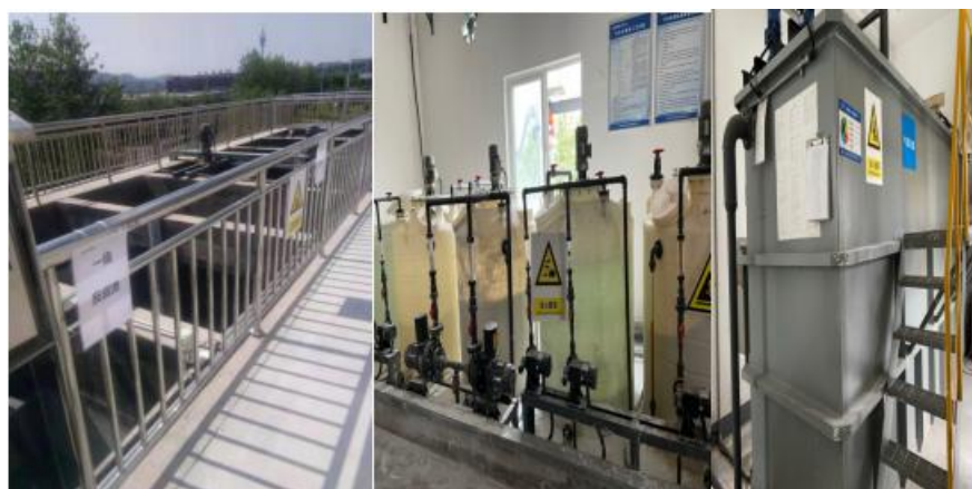
已建污水处理站
